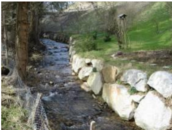
Abbildung 1: Ufersicherung mittels Blockmauer im Rüschelbach (Reigoldswil)
