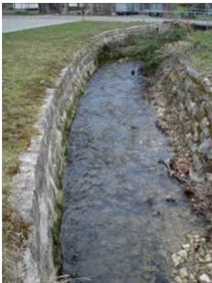
Abbildung 3: Uferschutz durch Trockensteinmauer im Wolbächli (Reigoldswil)
